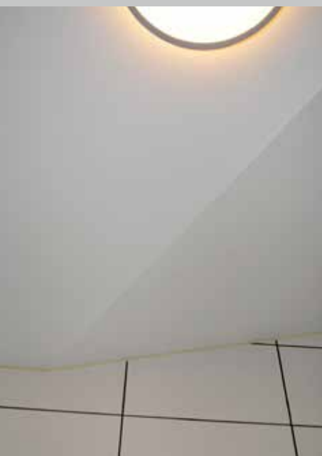
I annekset er det svært mange spesielle vinkler, som her i baderomstaket
